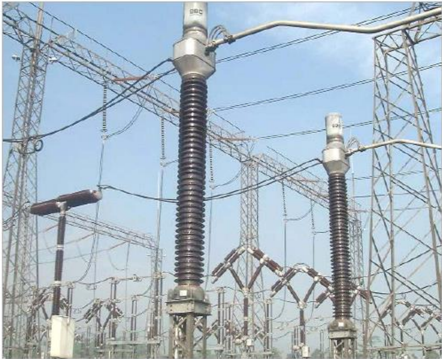
CIRCUIT BREAKER DAN CT GI TET 500 kV
