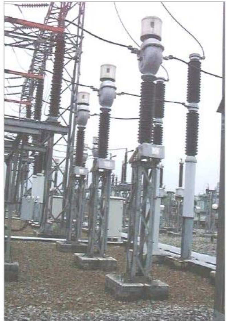
CT DAN LA 150 kV
